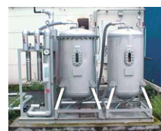
東京サイト八王子の地下水浄化装置
