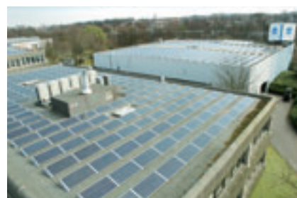
社屋の屋根全面に設置した太陽光発電設備
